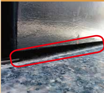
扉と床の隙間
